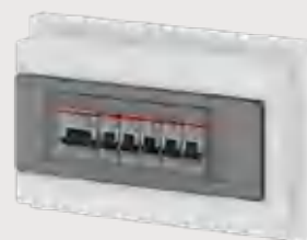
Щит с автоматами аварийного отключения питания и УЗО
