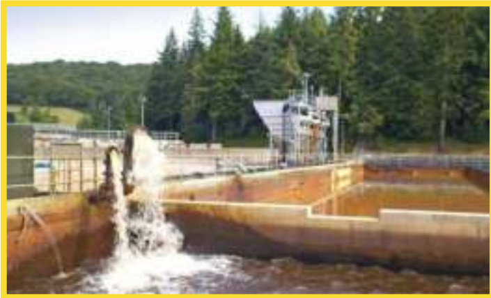
В удаленных водоочистных сооружениях насосы дозируют химические вещества, используемые для регулировки уровня pH
