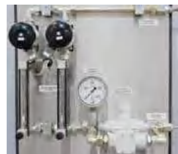
Система подачи негорючих защитных или реакционных газов
